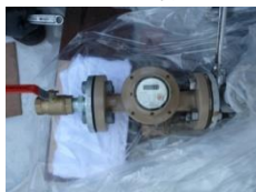
流量計設置状況
