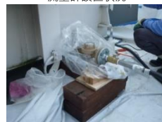
流量計設置状況
